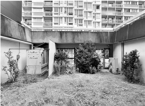
2020, patio nord (1), ce local technique à ciel ouvert sera déplacé dans le Parking
