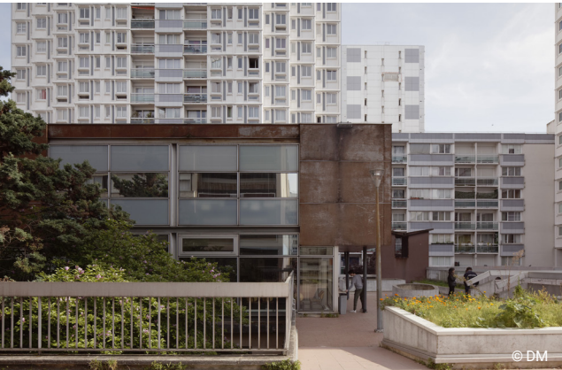
2020, le mur-rideau avec son parement bois fatigué.
